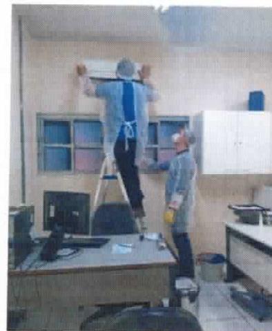
Figura 3 preventiva de ares-condicionados
