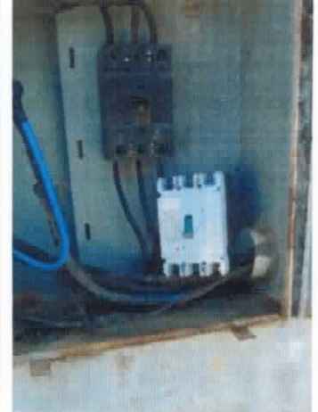
Figura 6. Toca do Disjuntor
